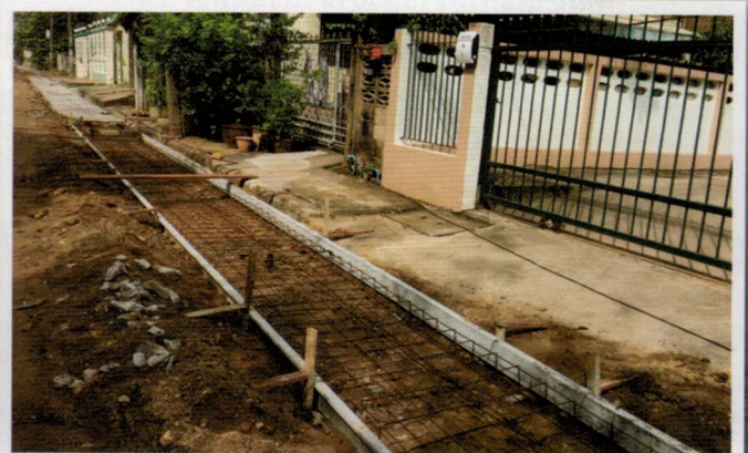
การควบคุมงานก่อสร้างท่อระบายน้ำงานรางวี ถนนศรีวิชัย ซอย 26 แยกซ้าย 3
