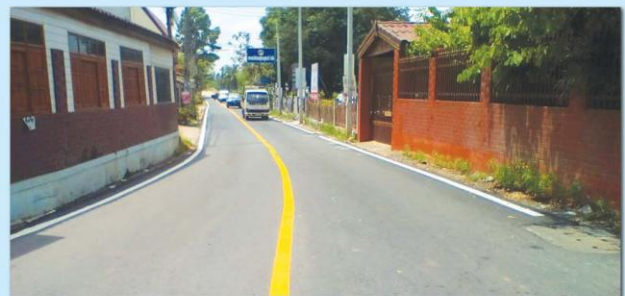
งานปรับปรุงผิวจราจรแบบแอสฟัลต์ติกคอนกรีต และตีเส้นจราจรถนนวัดโพธิ์ ซอย 31
